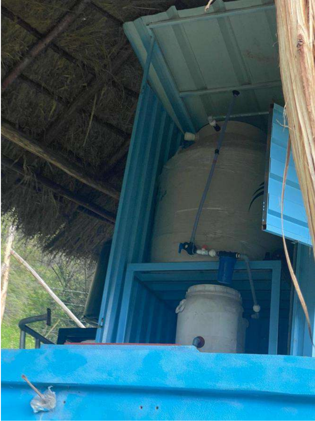
Fig. 11. Tratamiento de agua
