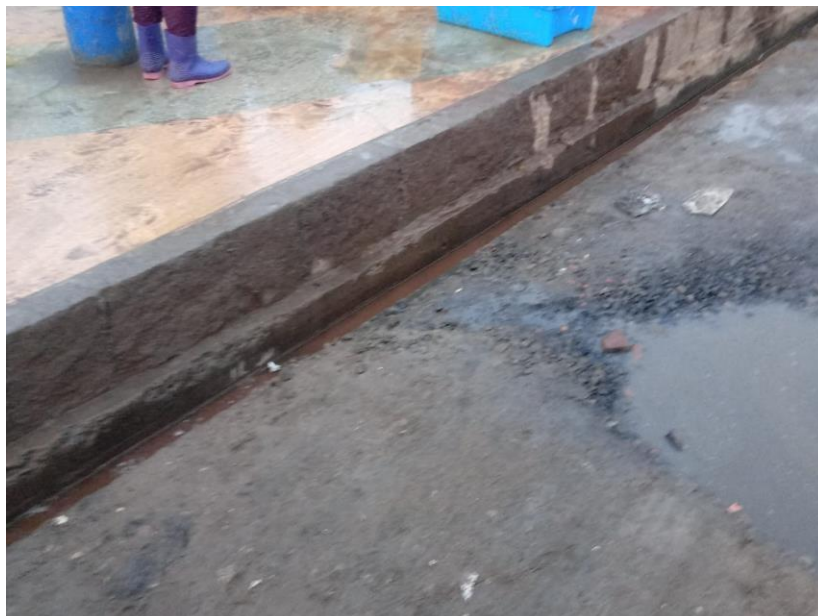
Figura 14 Canaleta de desagüe y residuo líquido en puerto Huacho
