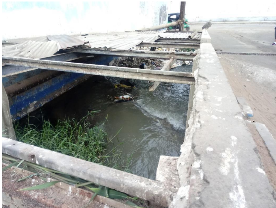
figura 21 Vertedero del pasaje AmincoFuente: El autor (2022)
