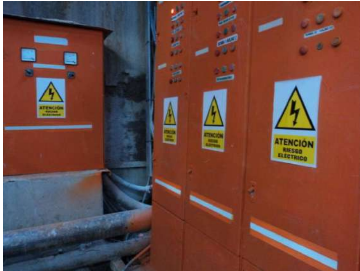
Foto N° 1: Señalización de tableros eléctricos
