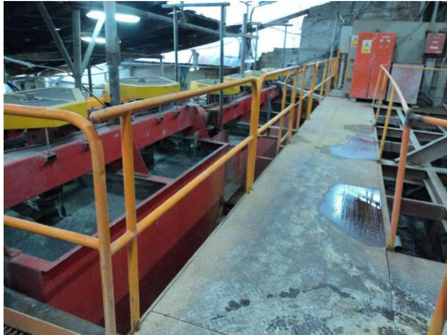
Foto Nº 7: Barandas colocadas frente a la celda de flotación.
