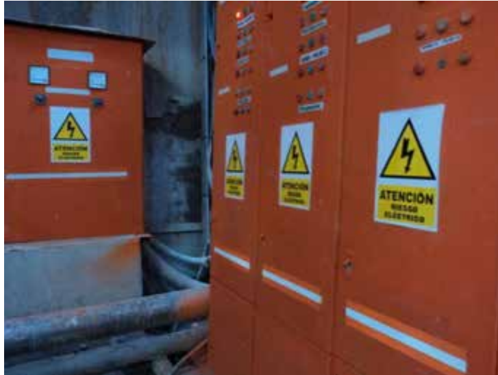
Foto N° 1: Señalización de tableros eléctricos
