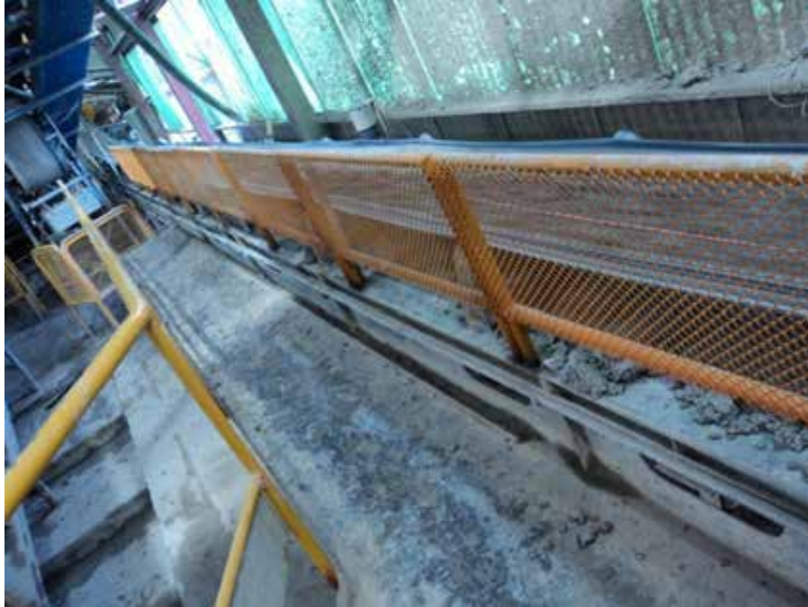
Foto N° 5: Vista de la protección lateral en una de las fajas transportadoras
