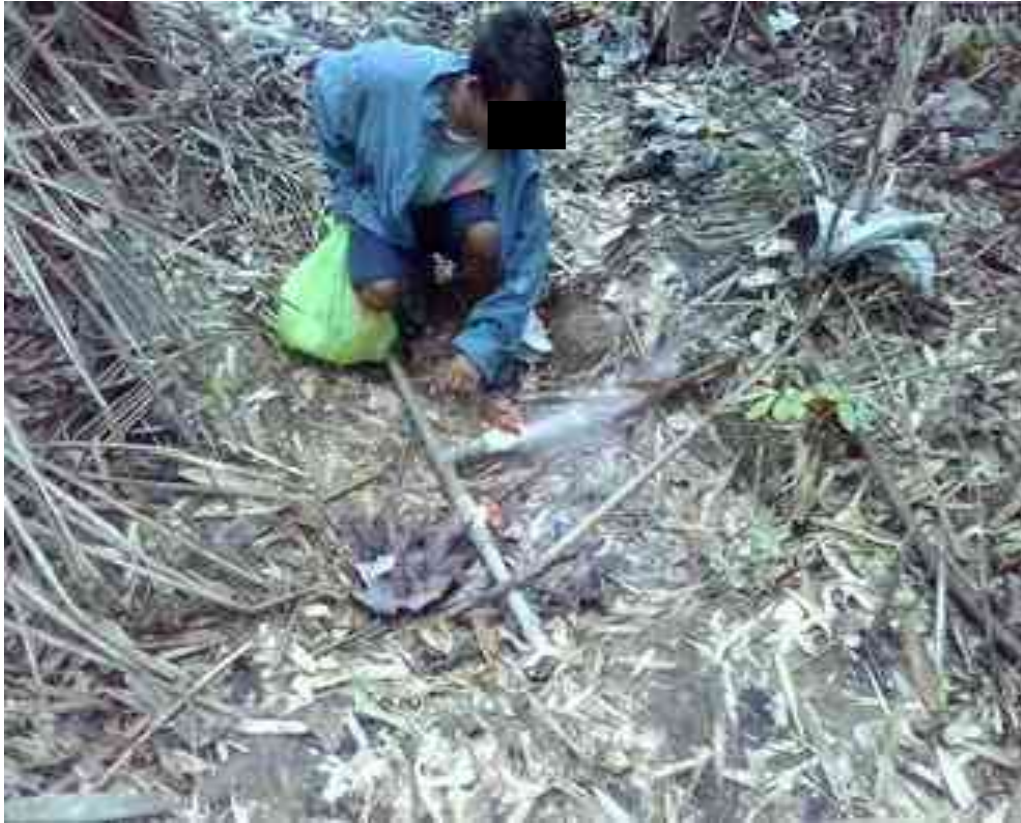
Figura 19: válvula de purga en la línea de impulsión expuesto a la intemperie sin caja de protección.
