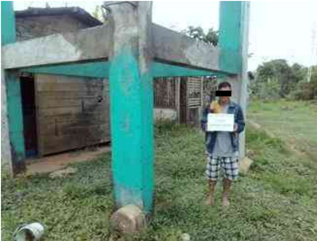
Figura 21: Reservorio de la CCNN Palma Real con una altura de 8m del nivel del terreno natural
