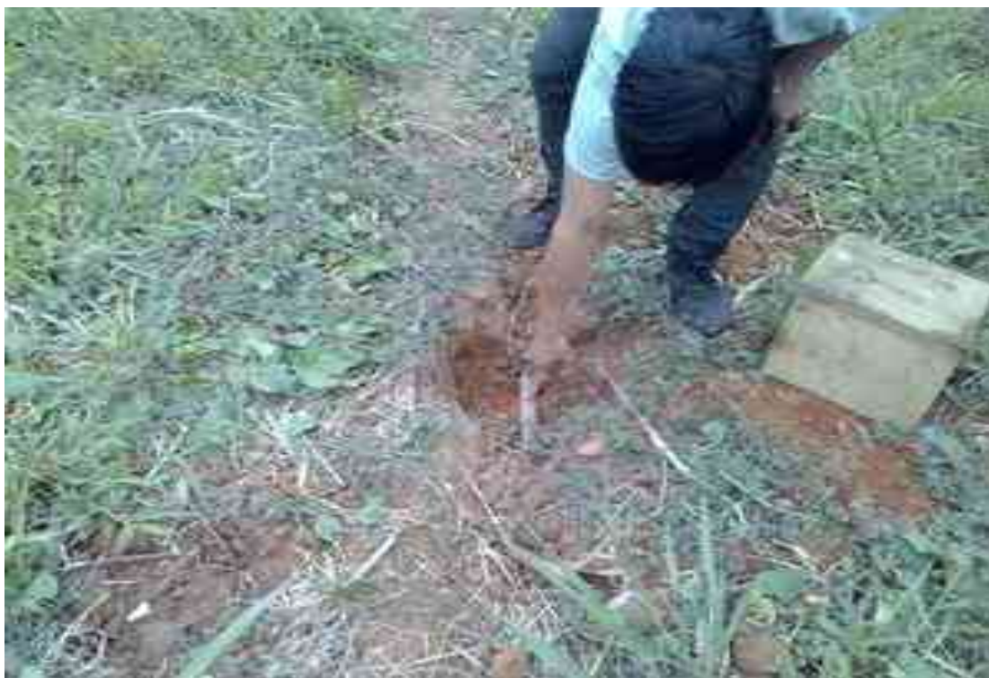
Figura 24: Llaves de paso hacia las viviendas sin caja de protección
