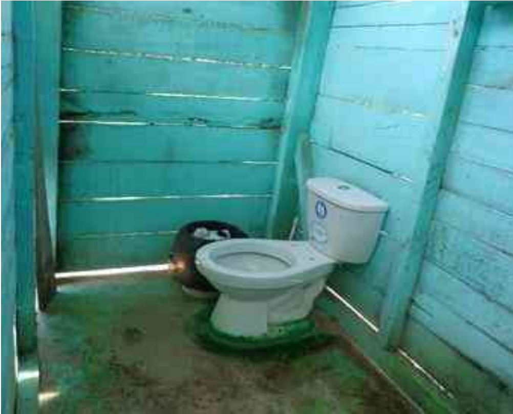
Figura 27: Elemento del cuarto de baño, inodoro de tanque bajo
