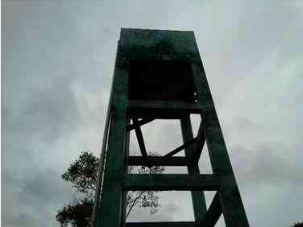
Figura 23: Base del reservorio elevado, se observa filtración del agua.
