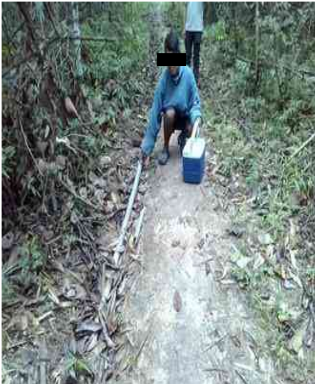
Figura 18: tubería de la línea de impulsión expuesto a la intemperie.
